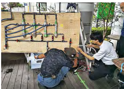
集水した雨水をろ過する様子。
