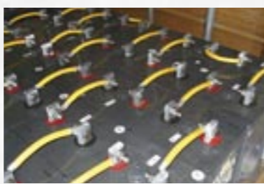
1台の発電機につき50個のバッテリーが設置されている
